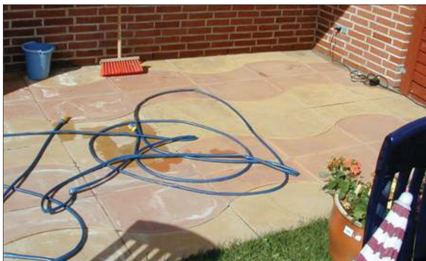
Almindelige kalkudfældninger på farvede sten. Højre del af belægningen er netop afsyret, og kalkudfældningerne er væk.
