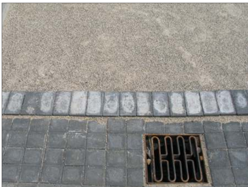
Kraftige kalkudfældninger på sorte sten. Er sådanne udfældninger tilstede ved lægningen, skal leverandøren kontaktes for at aftale det videre forløb.
